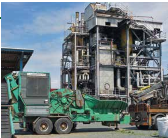
Impianto a biomassa, Güssing, (Austria)
