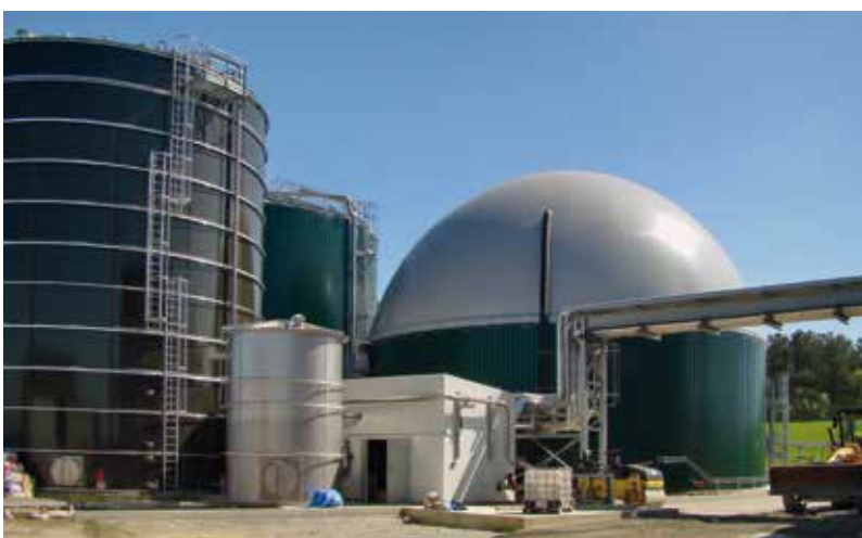
Impianto a biogas collettivo, Le Mene (Francia)
